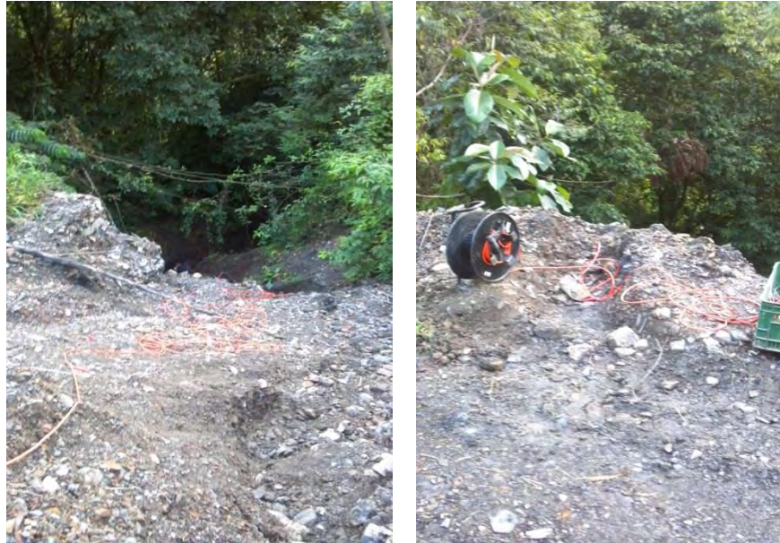
Fotografía 5. Parte media del deslizamiento.
