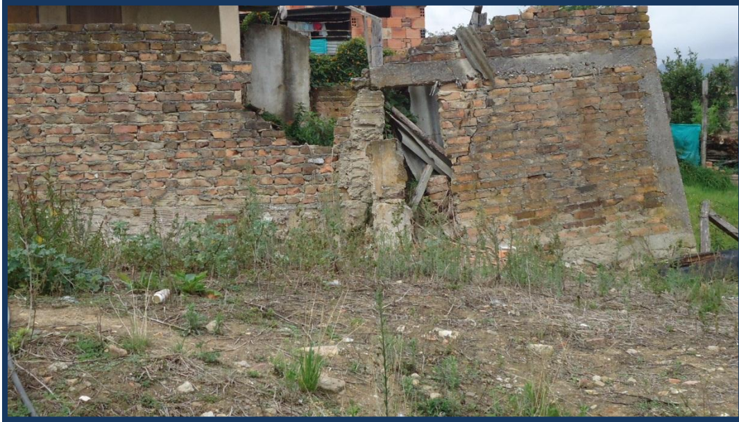
Fotografía 2. Colapso parcial. Vivienda afectada.
