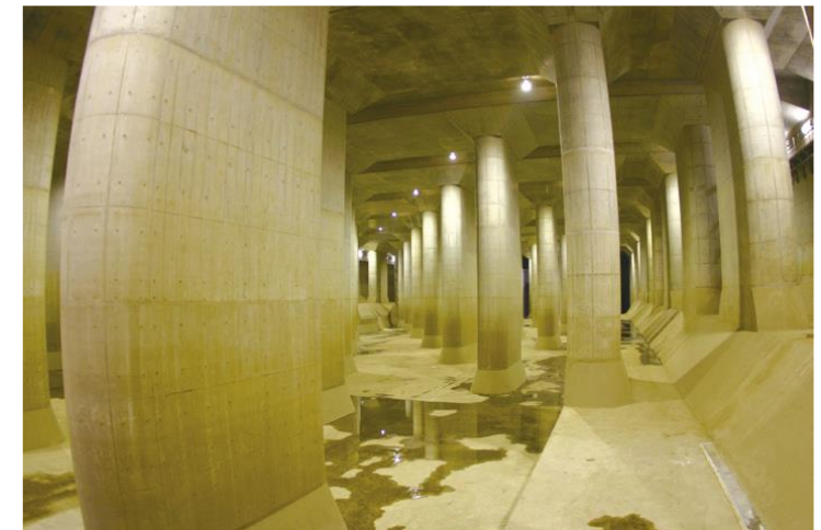
Canal subterráneo de descarga del área metropolitana Foto cortesía de MLIT, Oficina del Río Edogawa
