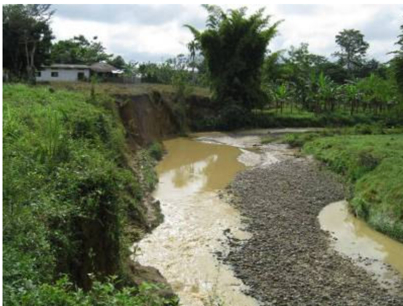
Figura 1-4. Socavación lateral, Inestabilidad de Márgenes debido al comportamiento sinuoso o meándrico. La Qda Piru antes pasaba a 100 metros de este punto atrás del cultivo (madre vieja), y ahora se encauso por delante del cultivo socavando lateralmente donde a pocos metros se encuentra una vivienda. En un Fuerte aguacero el residente nos dijo que la altura de la lamina de agua inunda el cultivo y queda al límite del borde superior de la margen (3 metros)
