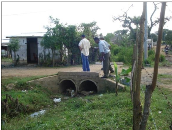
Foto. Alcantarilla de doble tubo en concreto con diámetro de 0.60, barrio San Gabriel
