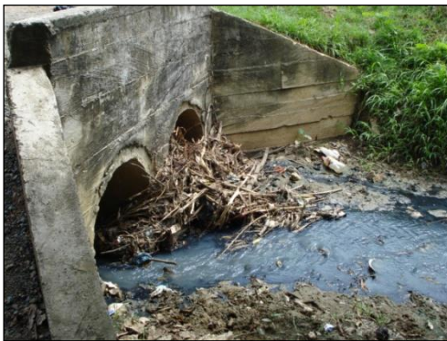
Foto Obstrucción de alcantarilla por desechos vegetales y basuras FUENTE PMGRP
