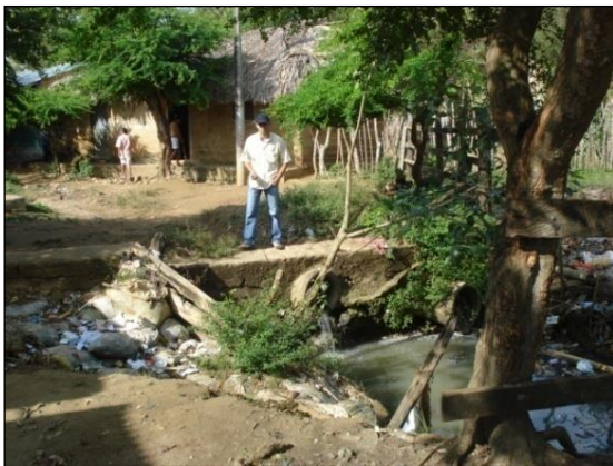
Foto. Cambio de sección del canal. Viviendas amenazadas por inundación. Vista aguas arriba, Barrio Bolívar FUENTE PMGRP
