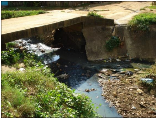
Foto. Estructura de paso deteriorada por socavación. Barrio San José. FUENTE PMGRP
