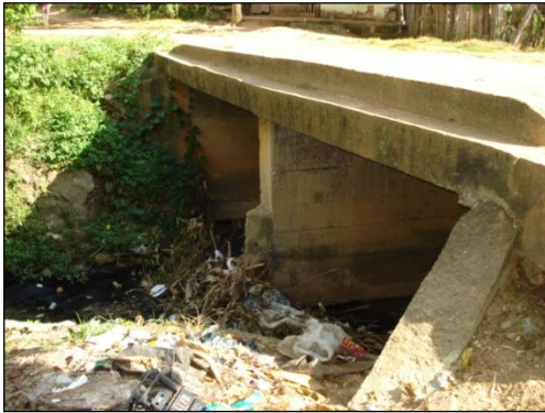
Foto Estructuras de paso obstruidas por taponamiento de materiales sólidos como residuos vegetales o basuras. Barrió San José
