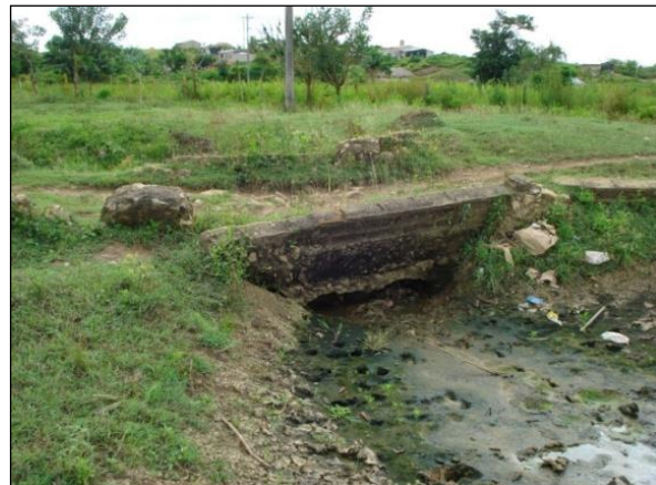
Figura 8 Estructura de paso, puente en mal estado, erodado y fallado por obstrucción.
