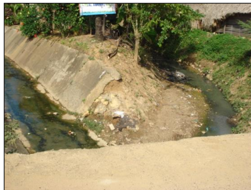
Foto. Punto de intersección de los canales y sitio de inundación. Barrio San José. Altura de la lámina aprox. 0.6 m FUENTE PMGRP
