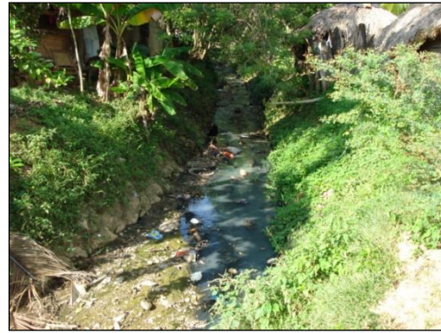
Foto. Perdida de la sección del canal por sedimentación y acumulación de residuos sólidos. Barrió San José. FUENTE PMGRP
