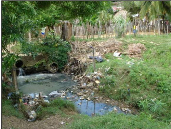
Foto Obstrucción de tubería por residuos sólidos y acumulación de los mismos en la sección del canal. Barrió Bolívar
