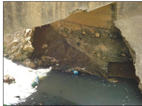
Foto. Detalle socavación estructura de paso. Barrio San José. FUENTE PMGRP
