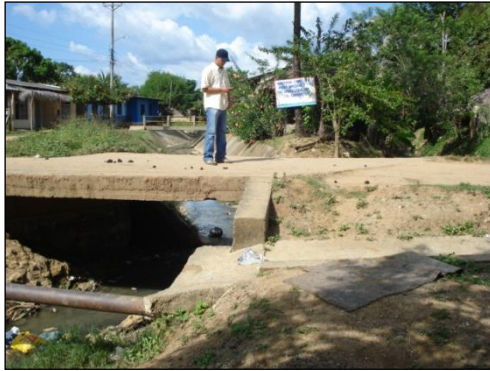
Foto. Estructura tipo Box, Punto de intersección de los canales y sitio de inundación. Se observa tubo metálico transversal que contribuye al taponamiento de la estructura. Barrio San José. Altura de la lámina aprox. 0.6 m sobre el nivel del puente.. FUENTE PMGRP
