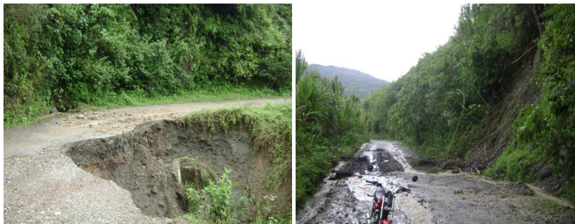
Vía Caldono – Porvenir Vilachi Pr 1+250Vía Siberia – Caldono K13+000. Fuente Alcaldía Municipal. Año 2012.
