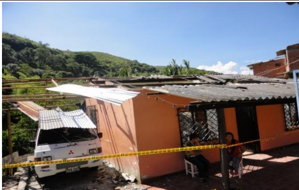
Imagen Daños en vivienda Vereda Porvenir Vilachí julio 2012. -Fuente Alcaldía Municipal.
