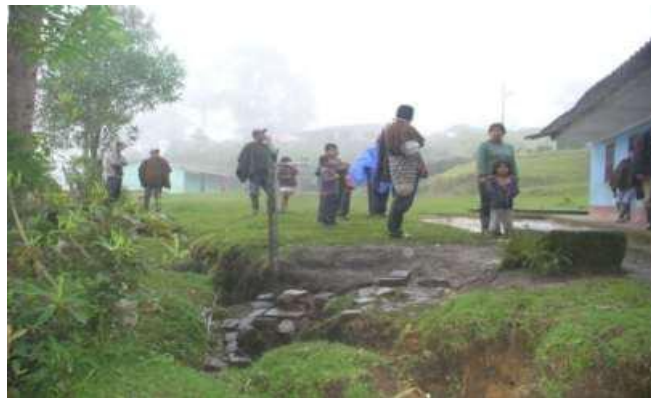
Agrietamientos cerca de la institución educativa en Carmen Pioyá 2009-Fuente Alcaldía Municipal.
