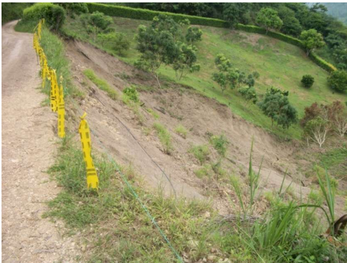
Deslizamiento Vda las Mercedes – Marzo 2010
