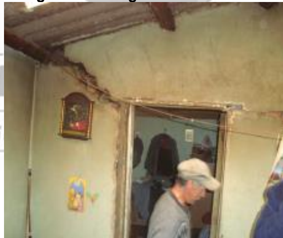
Fotografía 3.15. Agrietamiento vivienda Predio Las Lomas
