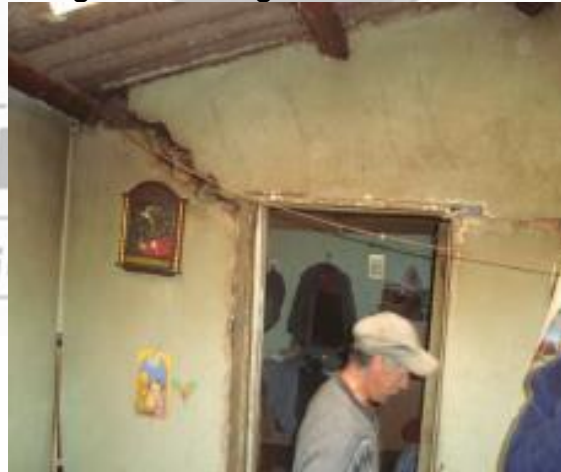
Fotografía 3.15. Agrietamiento vivienda Predio Las Lomas
