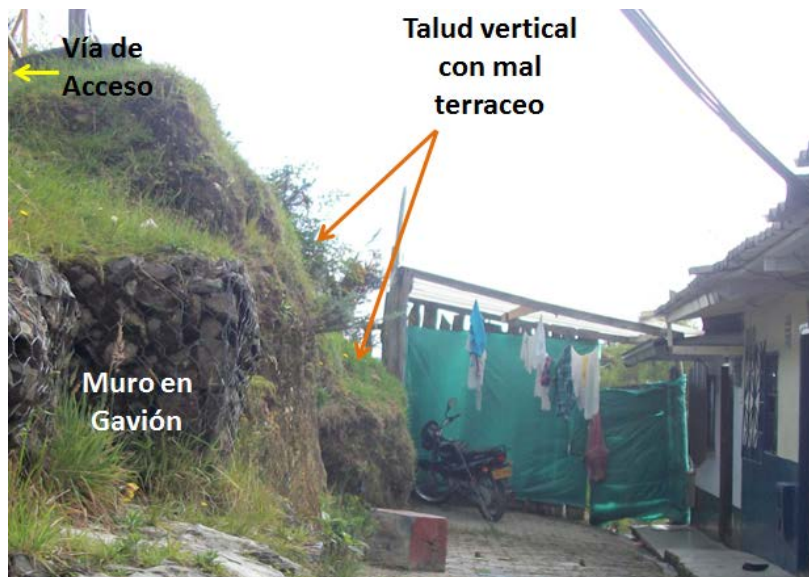
Figura 84. Talud Vertical con mal terraceo. Sector La Frontera. Municipio de La Unión. Tomado de CORNARE 2014.
