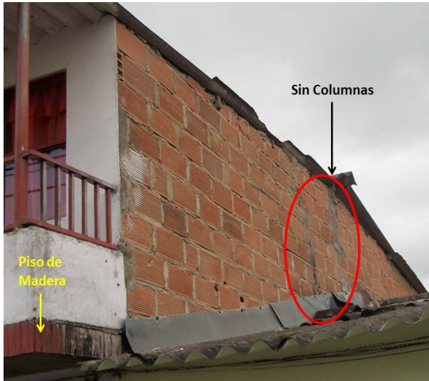
Figura 95. Déficit en la estructura de la casa. Sector La Frontera. Municipio de La Unión.
