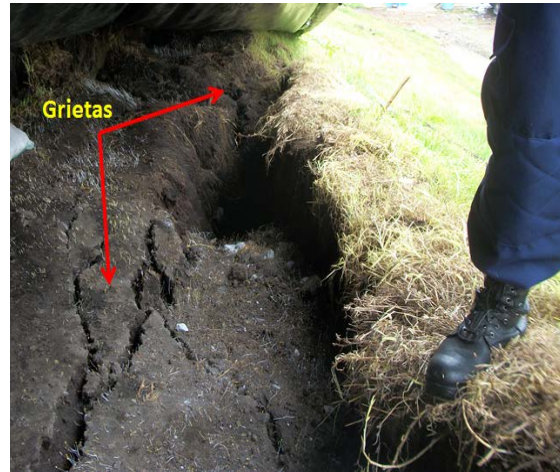
Figura 6. Grietas en la parte superior del talud. Sector La Bomba. Municipio de La Unión. Tomado de CORNARE 2014.
