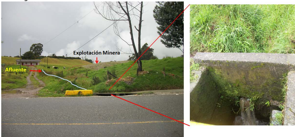
Figura 19. Diámetro inadecuado en obra hidráulica. Sector La Bomba. Municipio de La Unión. Tomado de CORNARE 2014.
