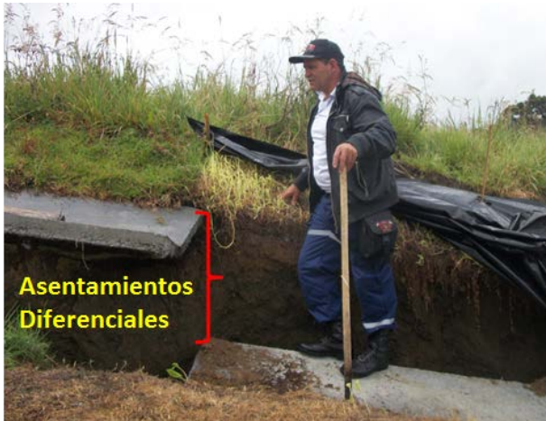
Figura 5. Asentamientos diferenciales. Sector La Bomba. Municipio de La Unión. Tomado de CORNARE 2014.
