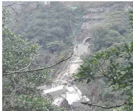
El accidente ocurrió en el sector conocido como Chirajara, una zona montañosa donde se construye la doble calzada de la carretera Bogotá-Villavicencio. Colprensa
