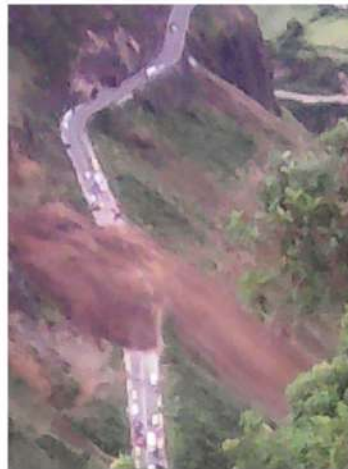
El deslizamiento se presentó en el kilómetro 66 de la Vía Pasto Tumaco.
