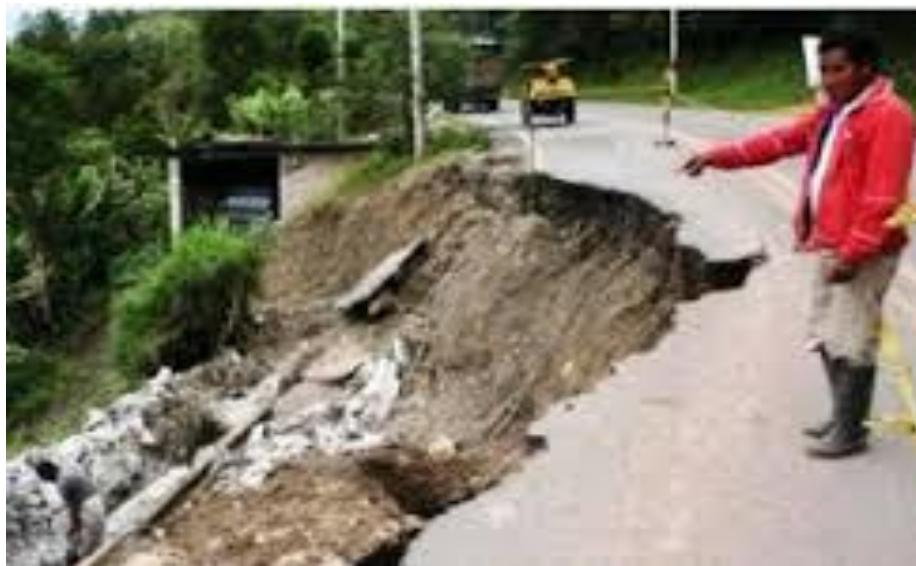
*Deslizamientos Zona urbana Municipio de Buesaco
