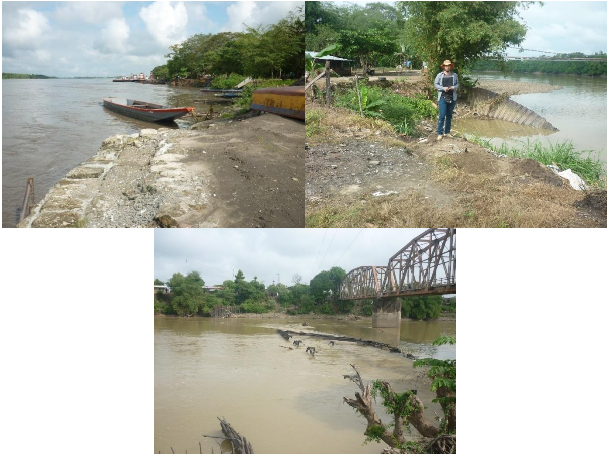
Figura 4-7. Erosión Lateral de Orillas ocasionada por la instalación de pilotes en el margen derecho del Río Sogamoso.
