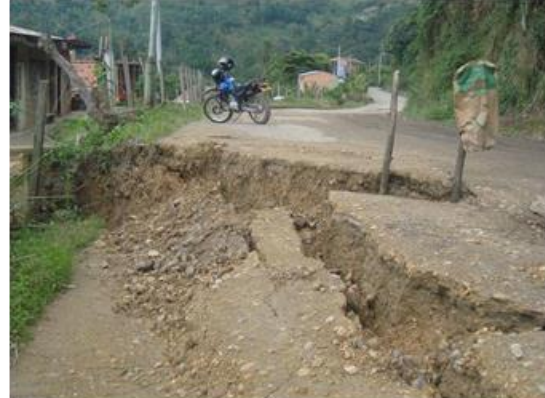
Foto 1.2 Desprendimiento de calzada
