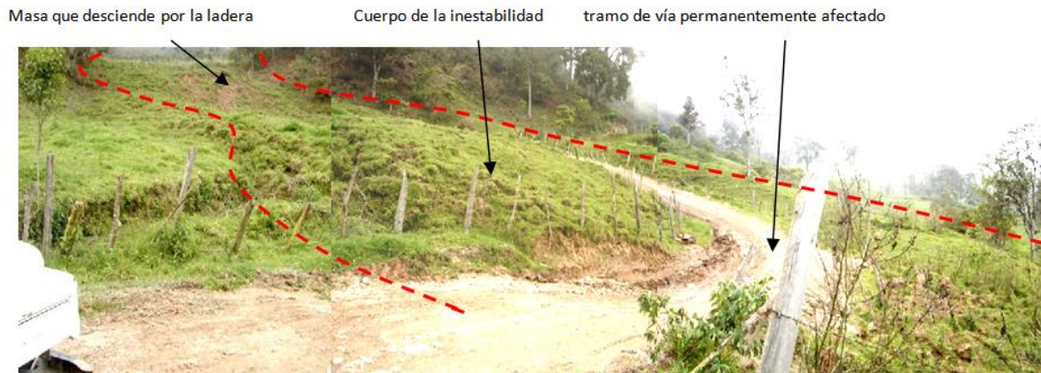
Foto 2.23. Detalle de un fenómeno de inestabilidad que afecta la vía que comunica las veredas de Laurel Alto y Laurel Bajo.
