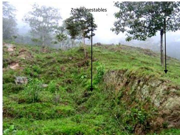
Foto 2.8. Detalle del desnivel o paso entre las zonas estable e inestable.
