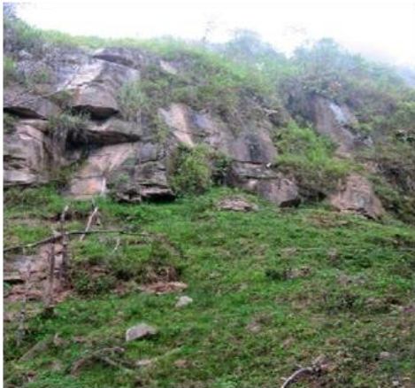
Foto 2.9. Detalle y panorámica del afloramiento o cortina rocosa, la cual efectúa un fraccionamiento de las inestabilidades.
