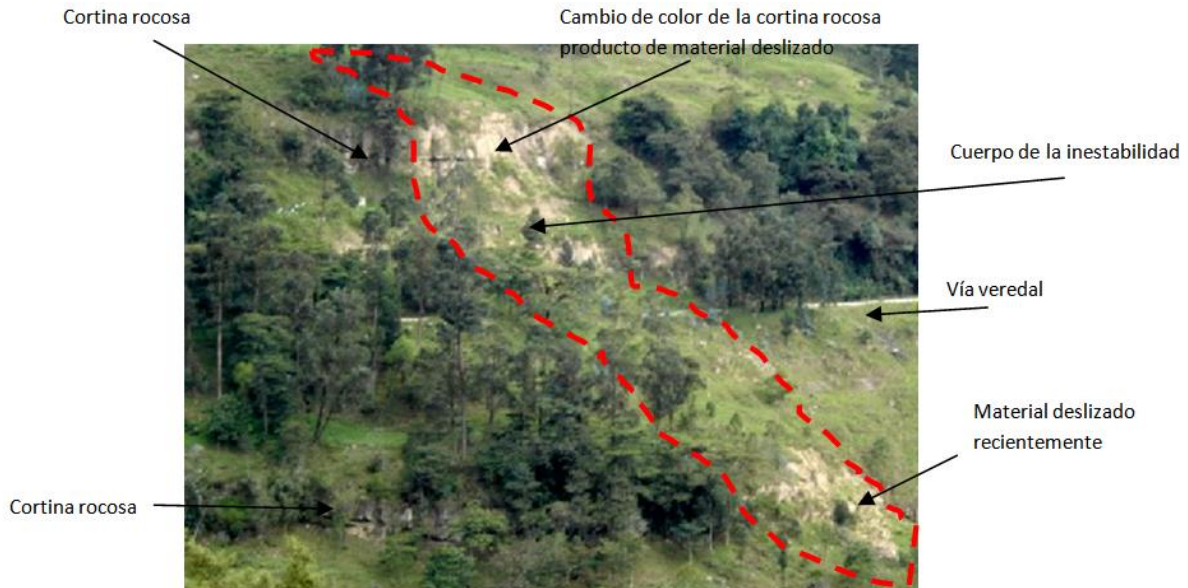
Foto 2.13 Detalle de un fenómeno de inestabilidad típico, los cuales se presentan en el tramo comprendido entre la Escuela Alejandría y la Escuela Andes.
