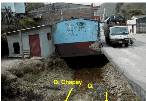
Figura 18. Vivienda sobre el cauce de la Quebrada La Cristalina en el área urbana
