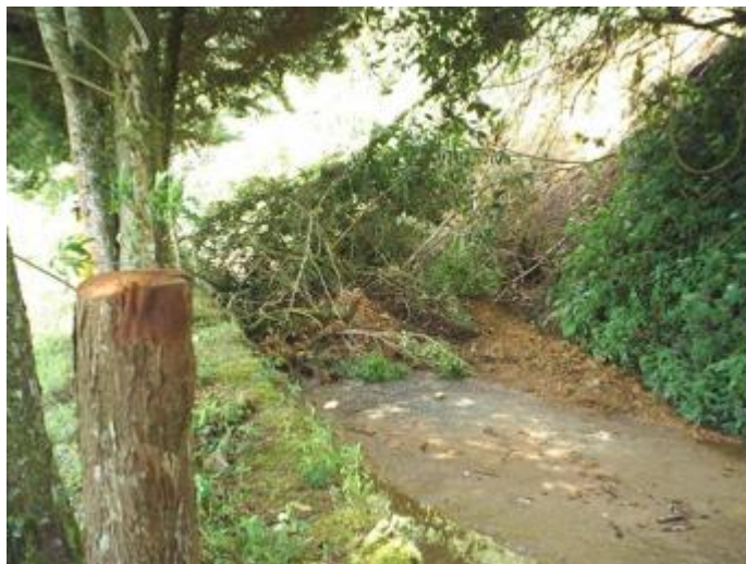
Deslizamientos entre la Vereda El Manzanillo y el Roblal.
