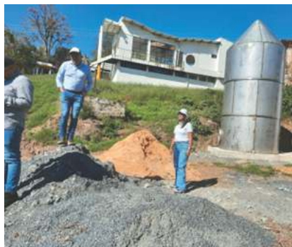
PTAR – Municipio de San Benito
