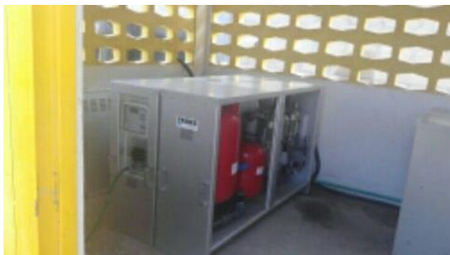
Planta potabilizadora ya en funcionamiento para Siapana
