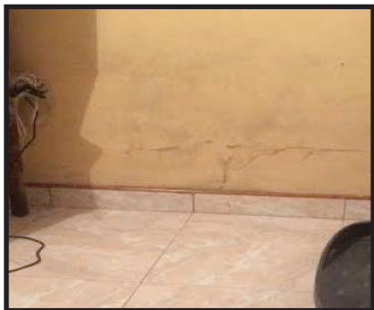
Grietas escalonadas y continuas a través del muro Fenómeno de La Niña. Cesar (Colombia), 2015. Fotografía tomada por: La UNGRD
