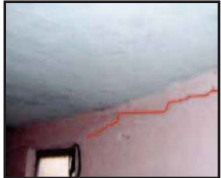
Mortero fisurado entre marco y la parte superior. Fotografía tomada de: Estudio de daños estructurales y no estructurales de las viviendas ubicadas sobre el eje vial de la Avenida Los Patriotas
