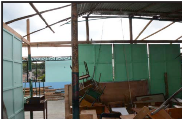
Deformación de la estructura o armazón de soporte de la cubierta Vendaval. Cauca (Colombia), 2015. Fotografía tomada por: La UNGRD
