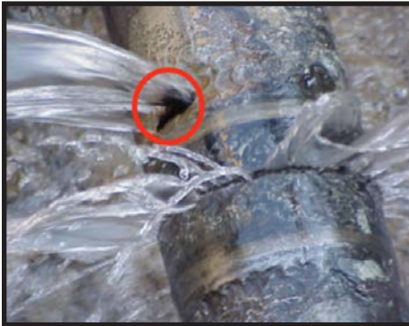
Fisuras o rotura en la tubería. Fotografía tomada de: Revista EJE 21
