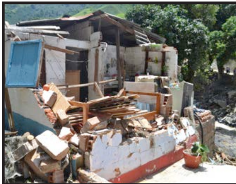
Colapso de cubierta Avalancha. Salgar (Antioquia), 2015. Fotografía tomada por: La UNGRD
