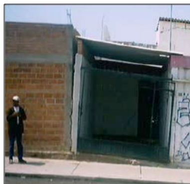
Asentamientos diferenciales. Fotografía tomada de: Metodología para la evaluación de la seguridad estructural de edificios, 2014.
