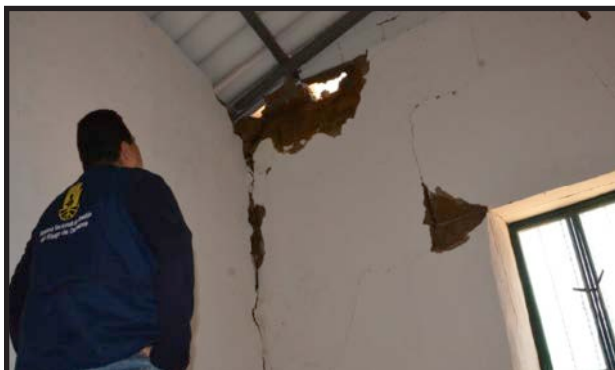
Falla entre la conexión viga-columna Sismo. Santander (Colombia), 2015. Fotografía tomada por: La UNGRD
