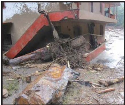
Desplome de muros de carga y muros divisorios Avalancha. Andes (Antioquia), 2015. Fotografía tomada por: La UNGRD
