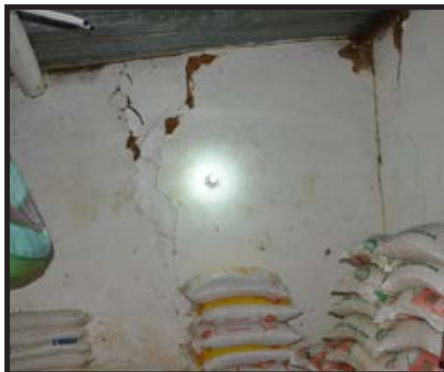
Formación de grietas horizontales y verticales Sismo. Santander (Colombia), 2015. Fotografía tomada por: La UNGRD
