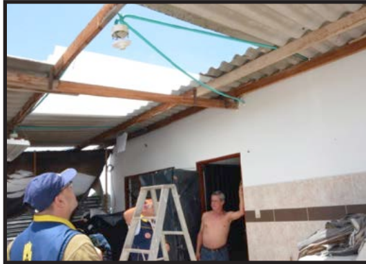
Desplazamiento de tejas pérdida falla o rotura vendaval. Cauca (Colombia), 2015. Fotografía tomada por: La UNGRD
