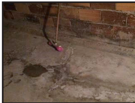
Grietas en la placa de piso Fenómeno de La Niña. Cesar (Colombia), 2015. Fotografía tomada por: La UNGRD
