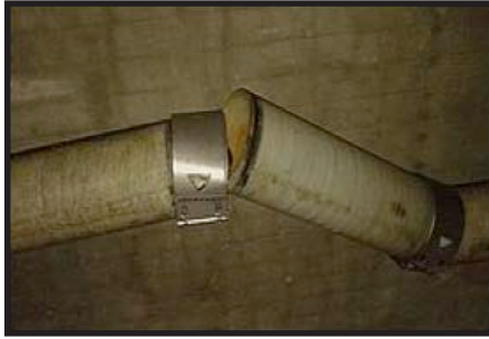
Desacople de los accesorios de la tubería Fotografía tomada de: El Diario Montañés; Victor Puente
