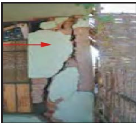
Falla por tracción diagonal por carecer de vigas y columnas. Fotografía tomada de: Manual para la reparación y reforzamiento de viviendas de albañilería confinada dañadas por sismo, 2009
