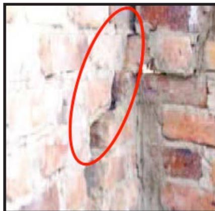
Desplazamiento horizontal a lo largo de grietas escalonadas. Fotografía tomada de: Estudio de daños estructurales y no estructurales de las viviendas ubicadas sobre el eje vial de la Avenida Los Patriotas
