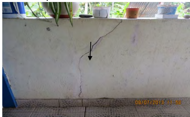
Fotografía 27. Agrietamiento de paredes en vivienda visitada.
