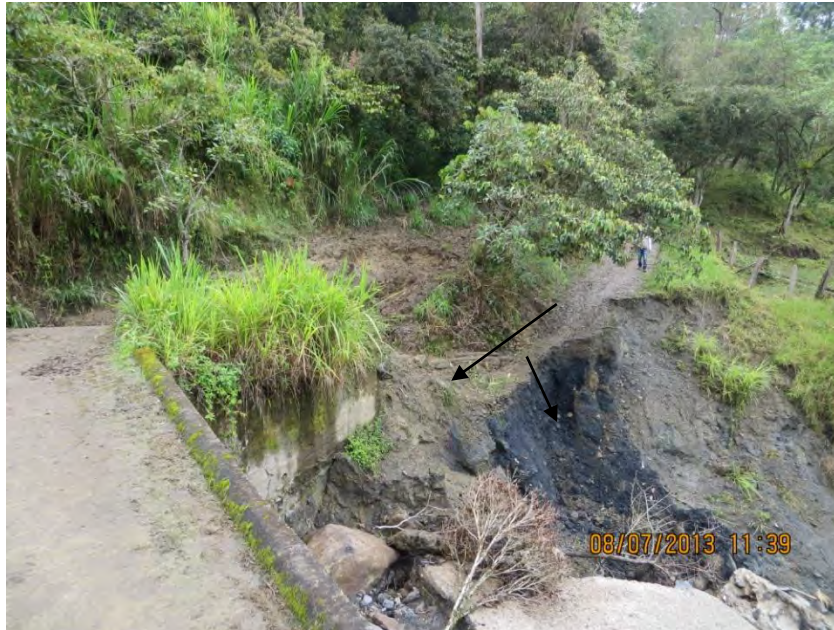
Fotografía 30. Paso peatonal peligroso.
