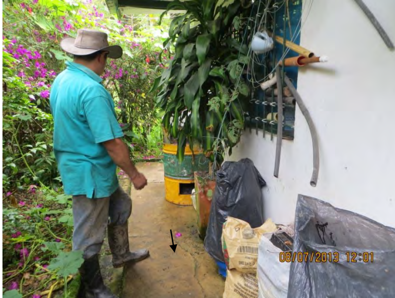
Fotografía 28. Grietas en el piso de la vivienda.
