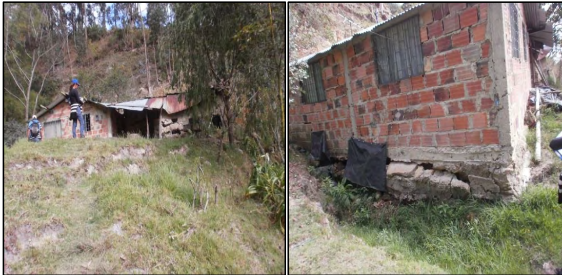
Fotografía 40. Viviendas ubicadas dentro de la zona de deslizamiento Nótese el tipo constructivo utilizado
