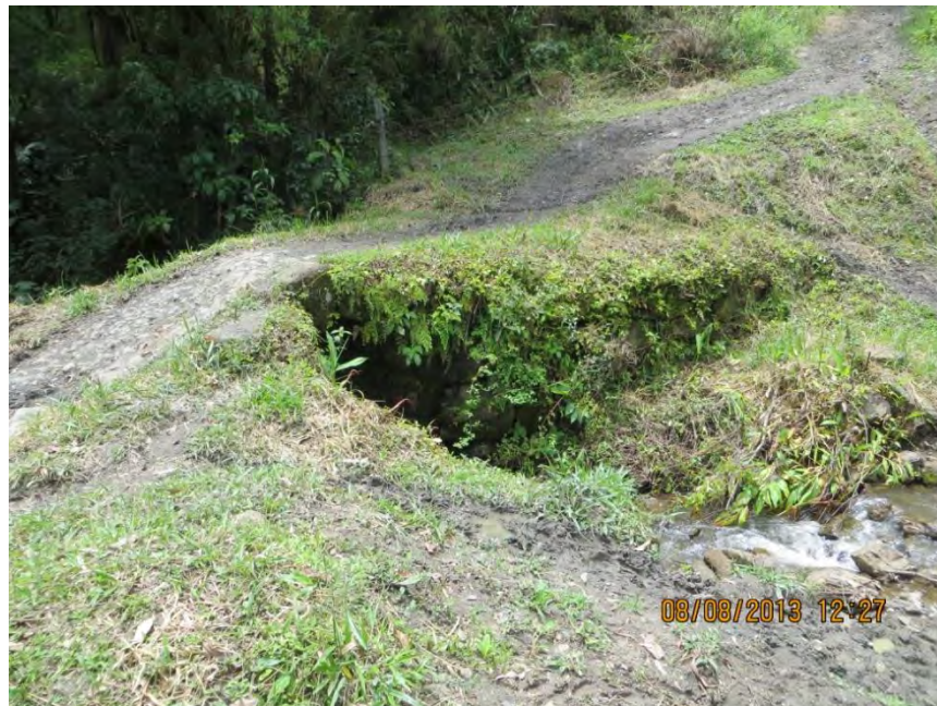
Fotografía 30. Parte alta del deslizamiento.
