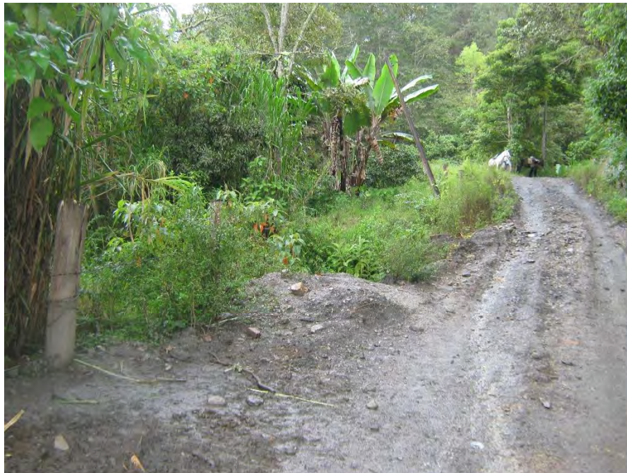
Fotografía 20. Parte del movimiento que afecta la vía
