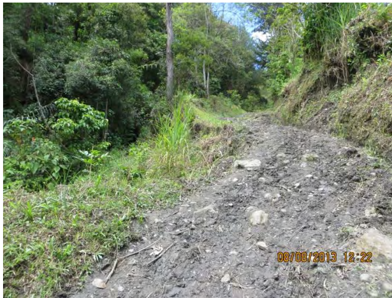
Fotografía 21. Vía vereda cucuava afectada
