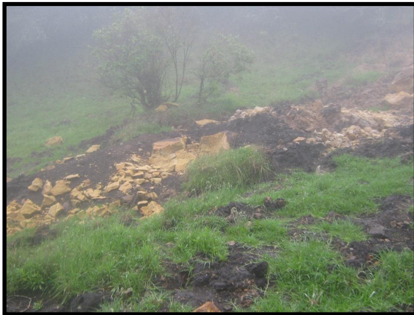
Fotografía 1. Zona de deslizamiento
