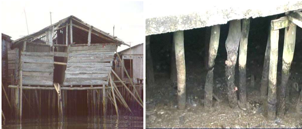
Figura 7. Vivienda en madera deteriorada.
