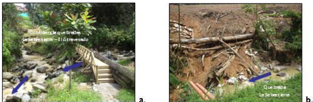
Figura 22. Quebrada La Sebastiana, barrio El Chocho. a) Desembocadura de la quebrada El Atravesado en la quebrada La Sebastiana. Esta área es altamente susceptible a la ocurrencia de avenidas torrenciales. b) Movimientos de tierra asociados al cauce.
