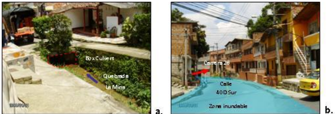
Figura 16. Quebrada La Mina, barrio La Mina parte baja. a) Inicio de la cobertura en box culvert del cauce. b) Primer tramo de cobertura inundable por insuficiencia hidráulica de la obra
