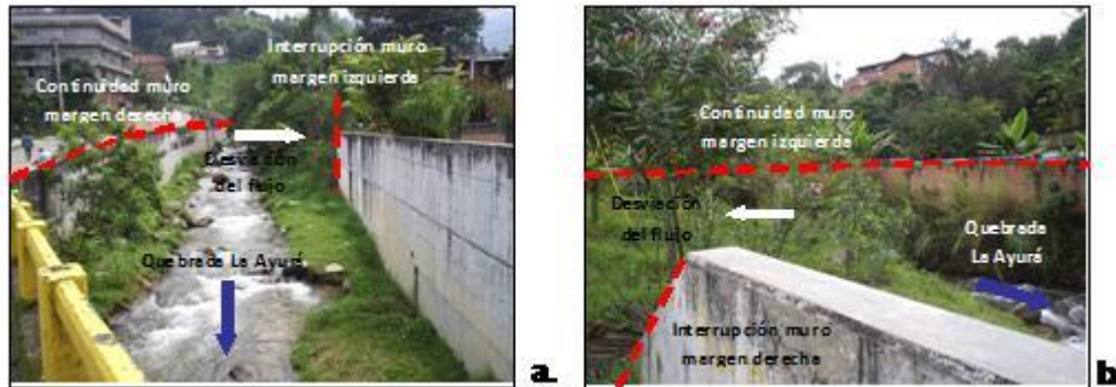
Figura 8. Quebrada La Ayurá. a) Muros de contención construidos en la entrada al barrio Chingú No. 2. Nótese la interrupción del muro hacia la margen izquierda de la quebrada. b) Interrupción del muro levantado en la margen derecha. El muro construido en la margen izquierda permanece constante hasta la desembocadura de la quebrada El Salado.
