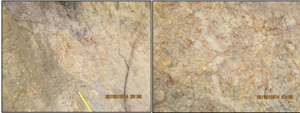
Fotografía 6.10 Vista de los niveles de limolitas muy meteorizadas y fracturadas (w3- w4), expuestas lateralmente al cuerpo del deslizamiento.
