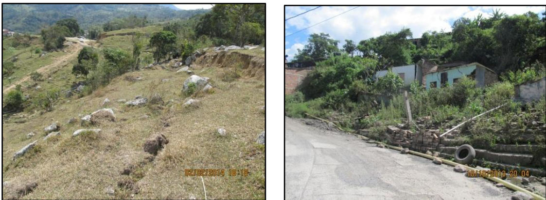
Fotografía 6.19 Vistas parciales del sistema de grietas del movimiento y viviendas
