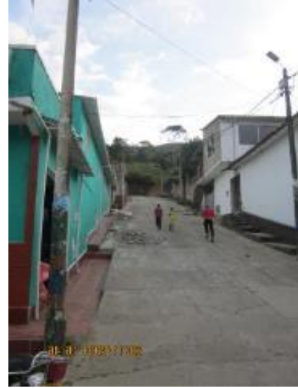
Depósito coluvial evidente cortado hacia el final de la vía
