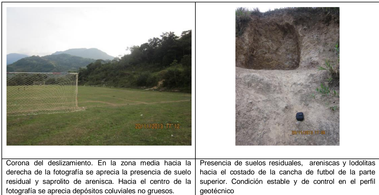
Fotografía 7.8 Parta alta del deslizamiento – cancha
