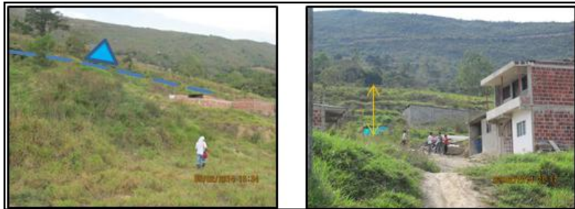
Fotografía 6.22 Vista del sector posterior del lote, afectado por el nivel freático colgado del sector occidental del predio
