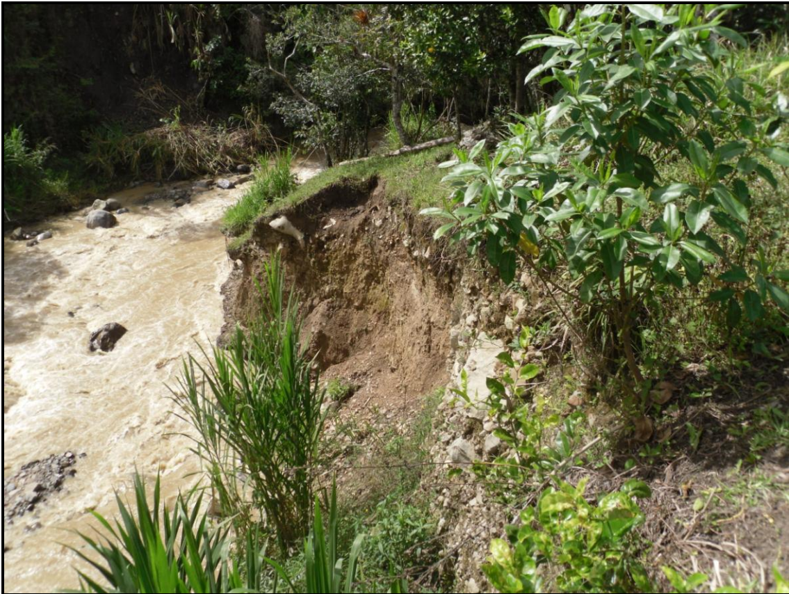
Fotografía 3-11 Socavación lateral producida por el Río Herradura
