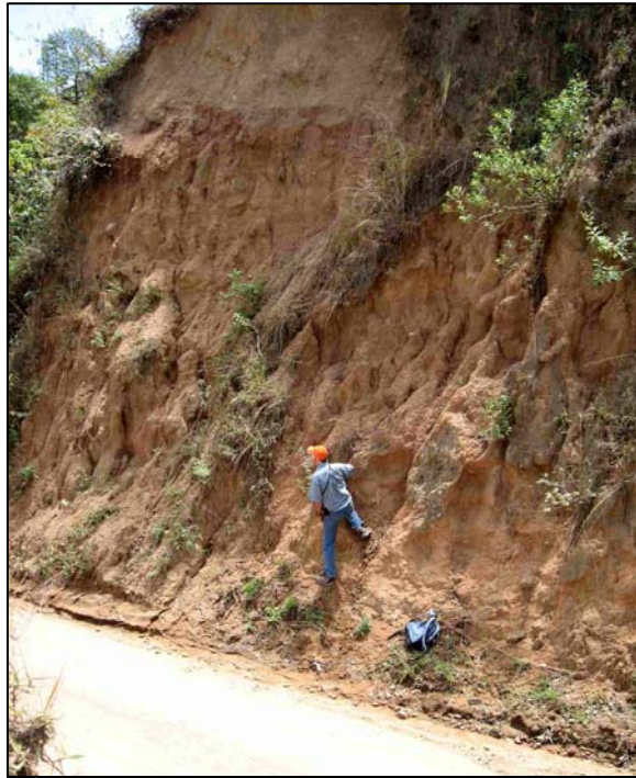
Figura 3.4.3.6. Corte de carretera en los materiales alterados de las rocas graníticas (saprolita), con espesores superiores a los 5 metros, material permeable y deleznable en ausencia de una cobertura vegetal buena y fuertes aguaceros intensos.
