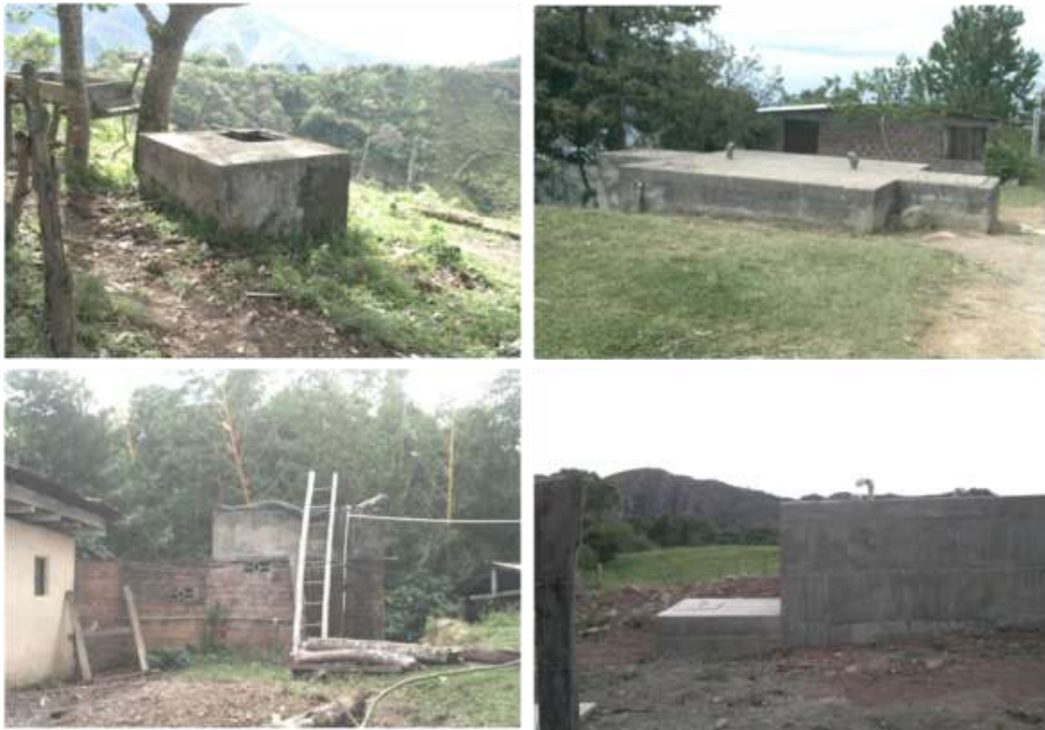
Figura 72. Sistemas de acueducto rurales que abastecen de agua a las veredas del municipio del Agrado.
