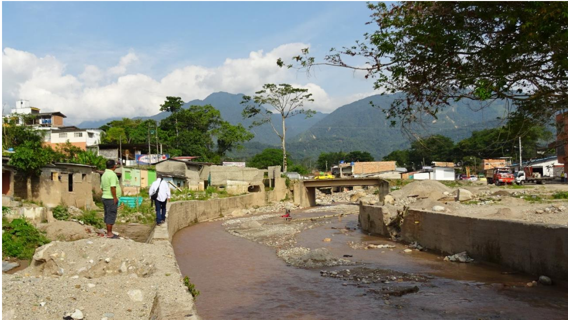
Figura 6-2. Puente en el que se presentó taponamiento. Ubicado sobre el río Sangoyaco antes de su desembocadura en el río Mocoa.
