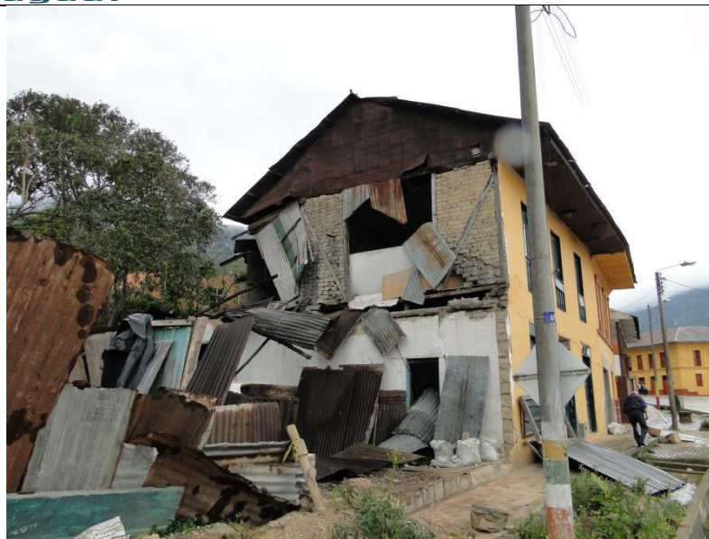
Ilustración 20. Casa que amenaza ruina en frente a la Estación de Policía
