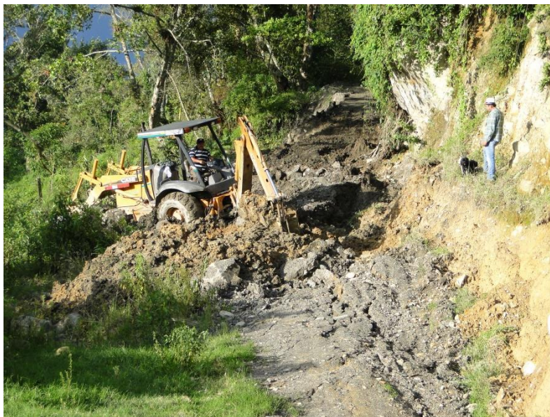
Ilustración 13. Remoción en masa y pérdida de la Banca vereda Garbanzal por el camino de herradura
