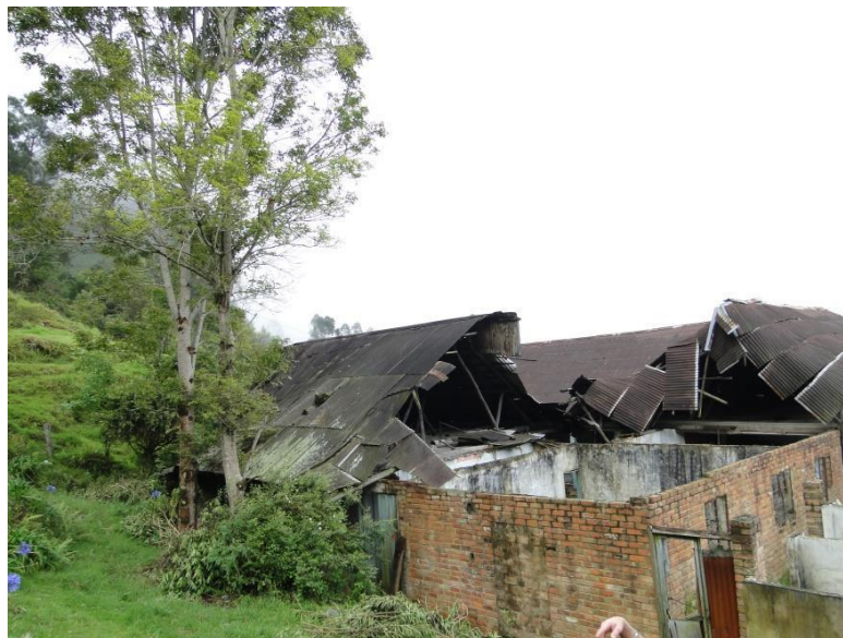
Ilustración 21. Casa de la Gobernación que amenaza ruina en el marco del parque de Albán conservación histórica
