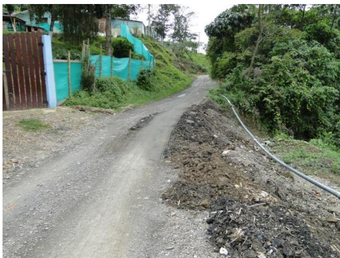
Ilustración 12. Remoción en masa y pérdida de la banca escuela Guayacundo Bajo
