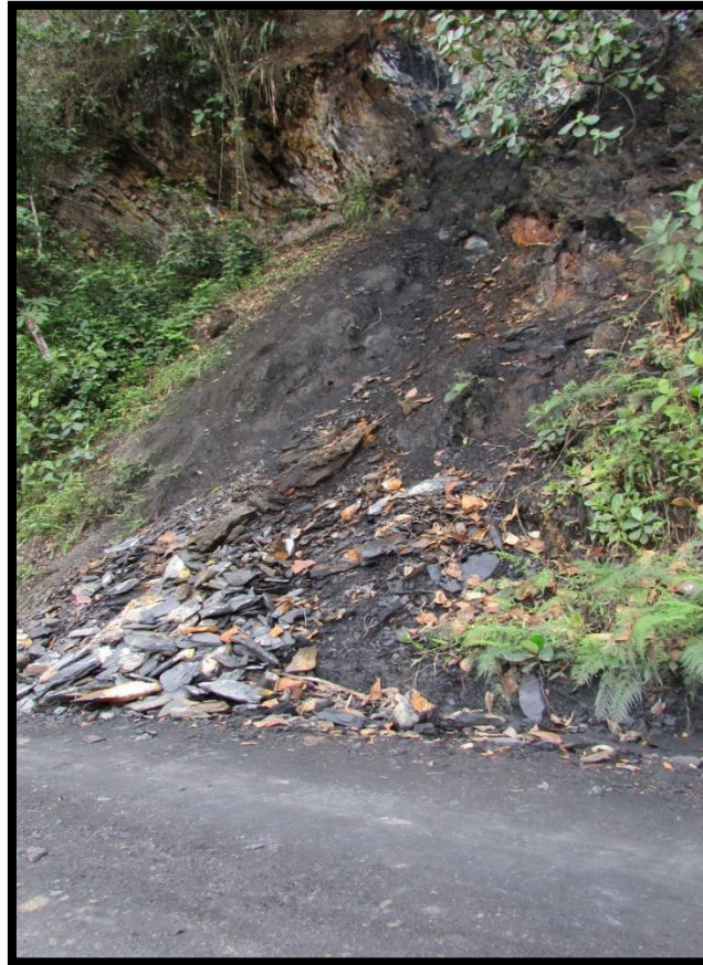
Figura 16. Derrumbe vía Peña Blanca. 74^{\circ}15'25,3''W ; 5^{\circ}7'4,05'' N .
