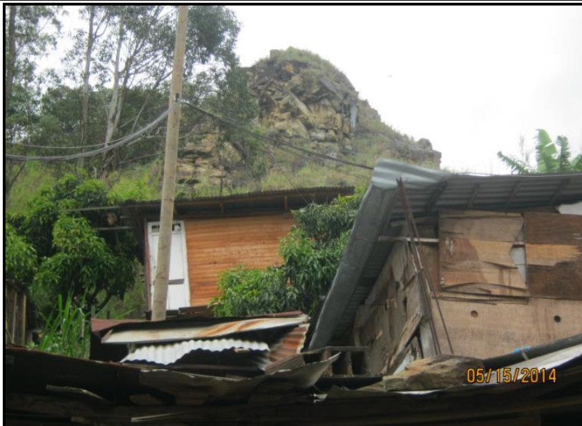
Localización de las viviendas directamente debajo del talud
