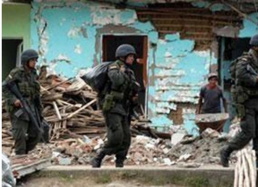
Imagen 31. Afectación por vendaval de una vivienda en Caldono, Cauca.
