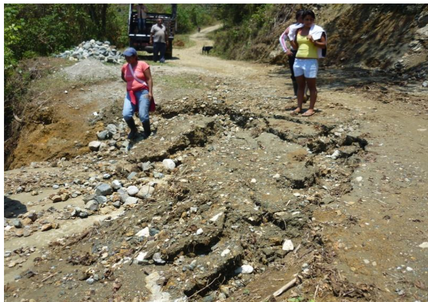
Imagen 2. Afectación a la vía que comunica la vereda Monterredondo con la vereda El Horno.
