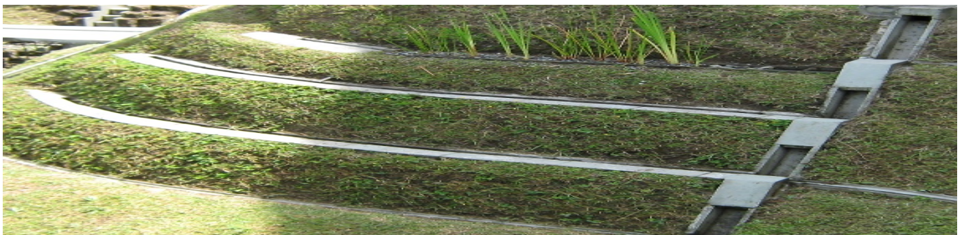
Sistema de canaletas para manejo de aguas lluvias y terraceo del talud, fuente: UNGRD (2009). ↗
