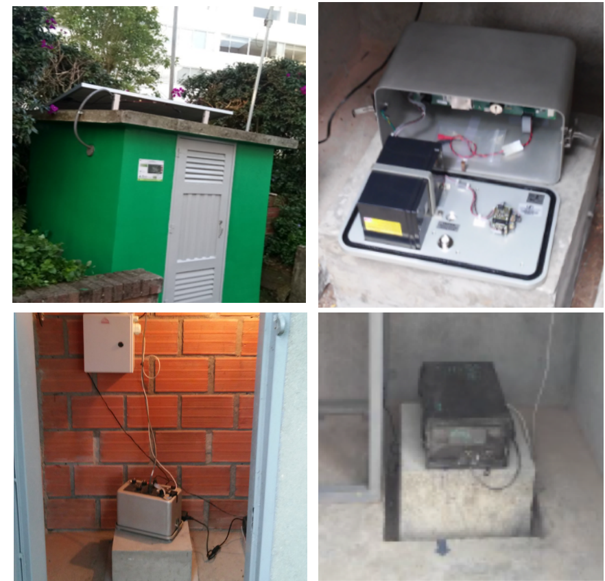
Figura 3. Fotografías de las estaciones de la red de acelerógrafos. Fuente propia
