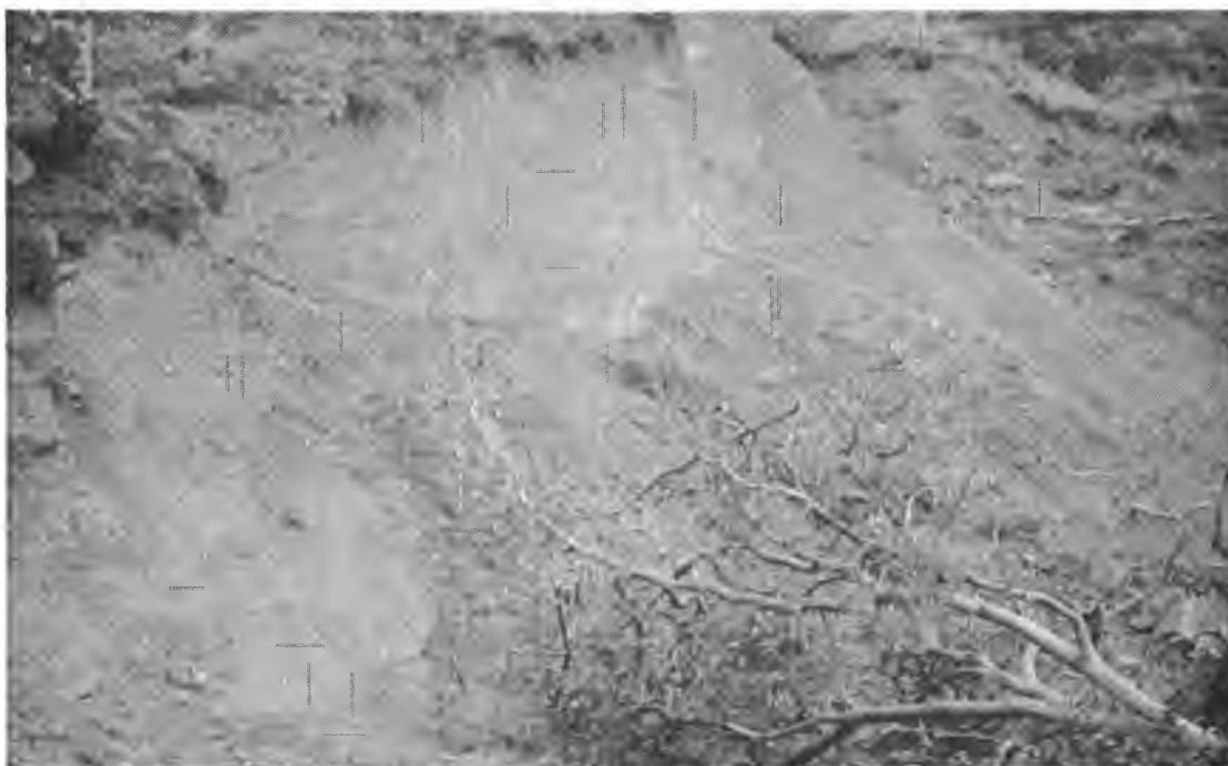
DESLIZAMIENTO VEREDA BOLIVIA
